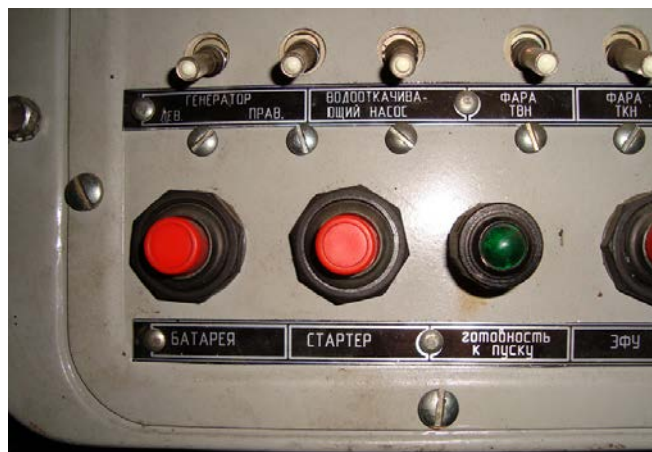
Рисунок 7.ОК-25 – Выключатель дистанционный аккумуляторных батарей на щитке приборов
